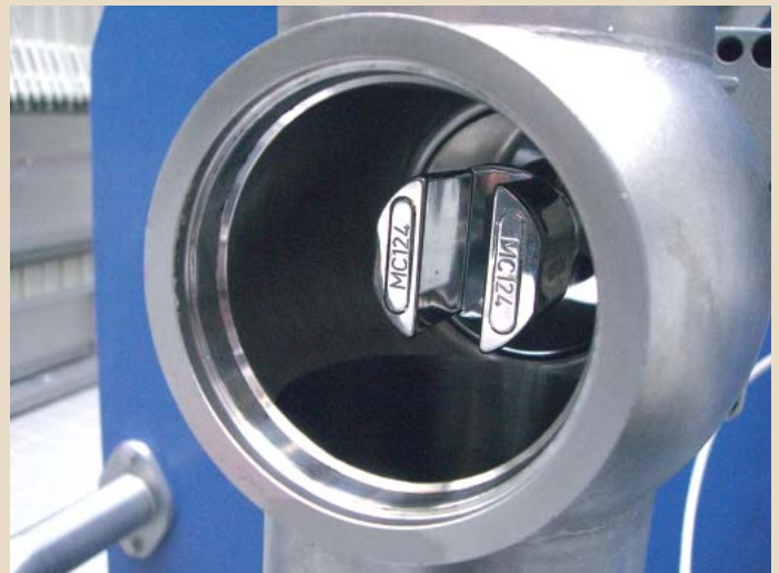
Abb. 3 Blick auf die Messgabel nach CIP in der Rohrleitung
